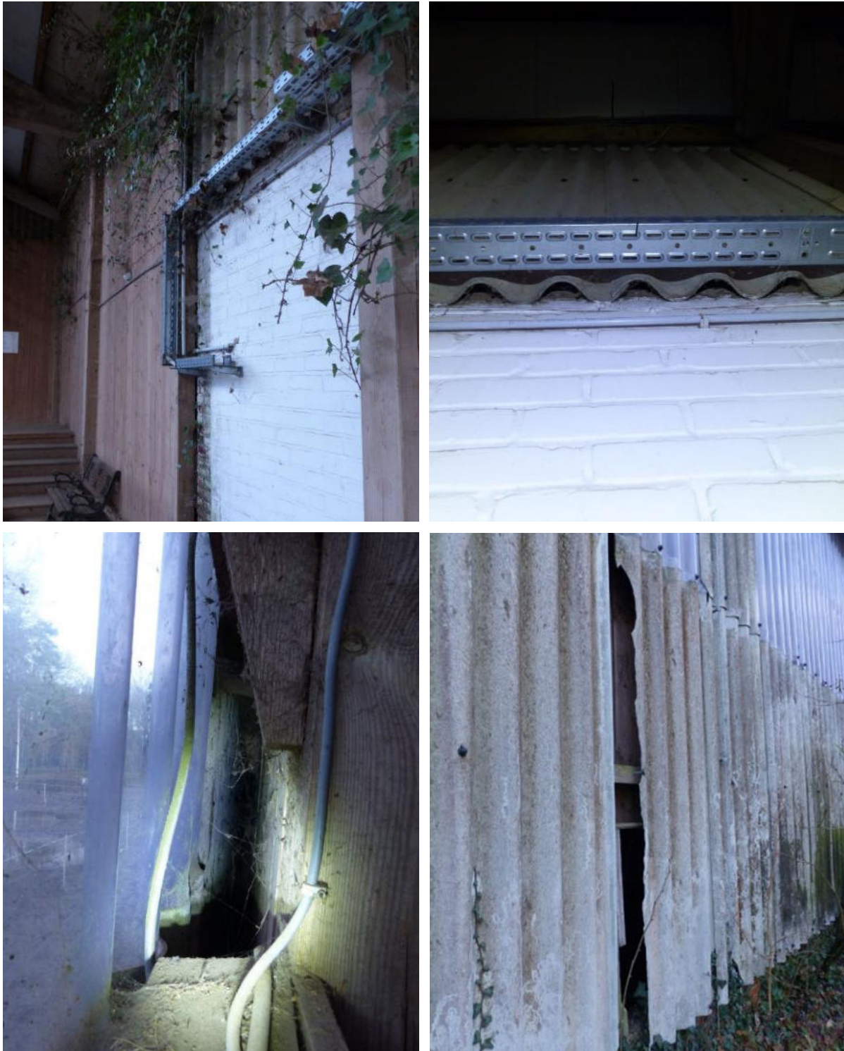
Abb. 14: oben links: Holzverschalung innen entlang der Außenwände der Reithalle, rechts oben: Tagesversteckmöglichkeit innen; unten: Einflugmöglichkeiten von innen und außen hinter die Holzverschalung der Reithalle
